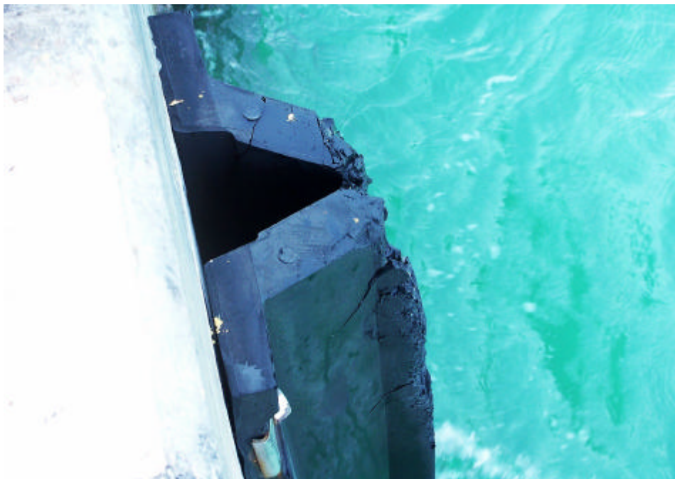
東龍洲(北)碼頭的損壞橡膠護舷
